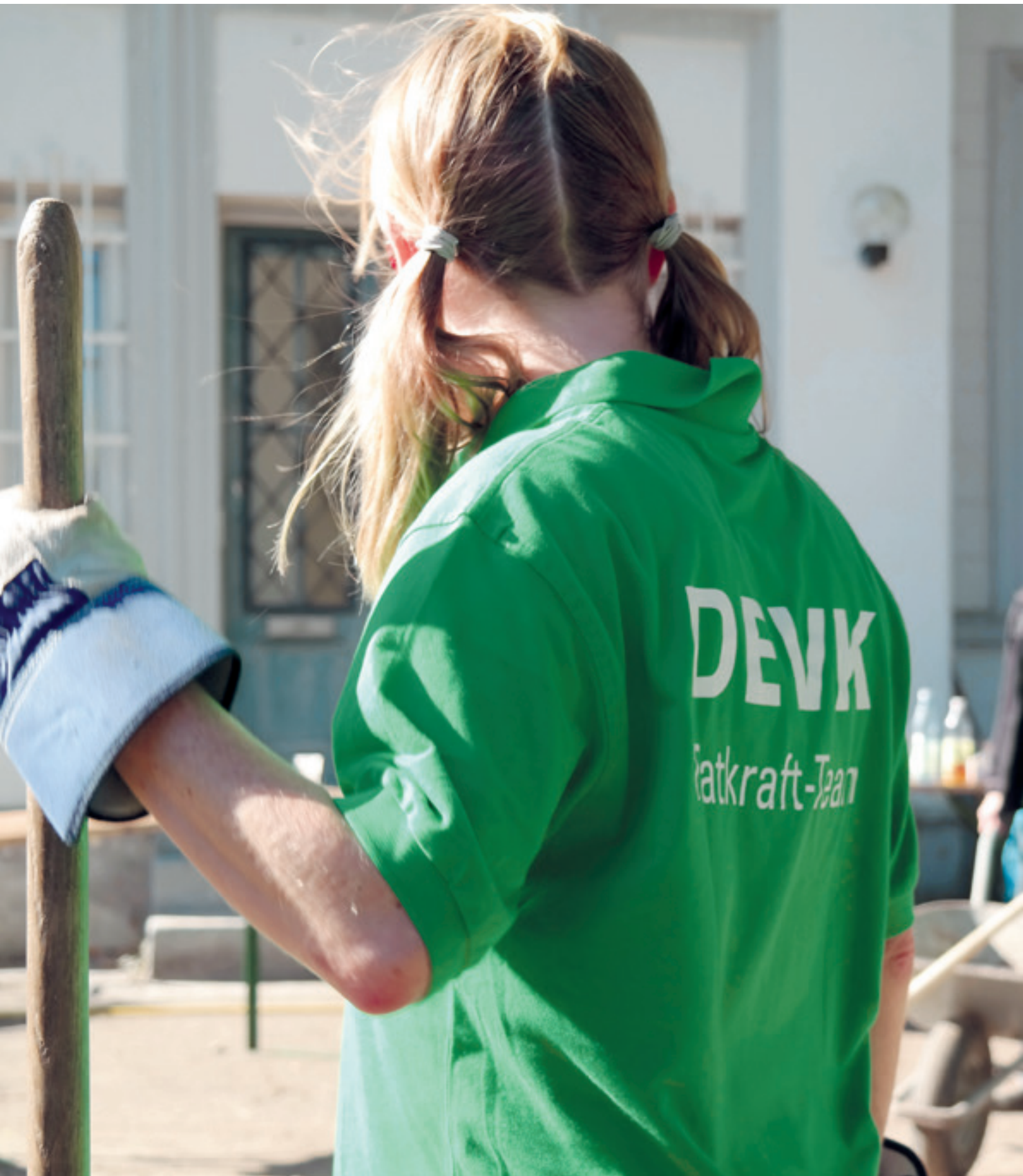
Graben, schaufeln, roden – in Wuppertal leistete das Tatkraft-Team ganze Arbeit. So wurde der Außenbereich der Lebensgemeinschaft für Autismus komplett umgekrempelt.
